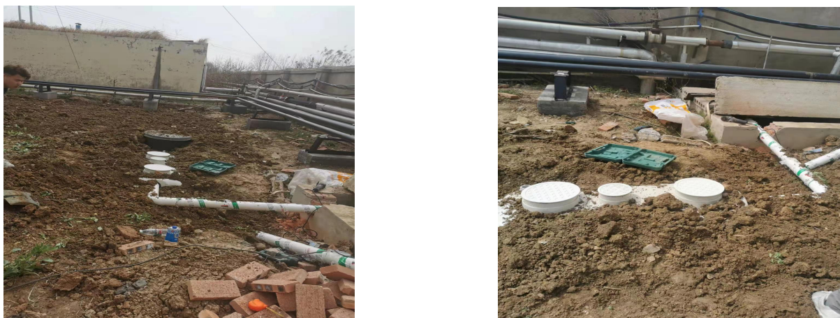
图 7-2 西风井场地地埋式污水处理设施
